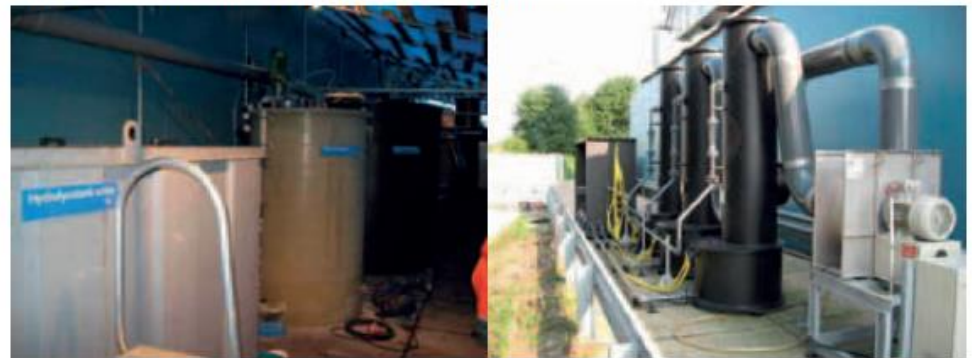
HYDROLYSEREACTOR EN STRUVIETREACTOR (LINKS) EN STRIPINSTALLATIE (RECHTS)
