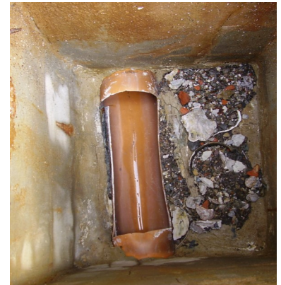
Resten van afval die in de buizen neerslaan, in dit geval steenpuin.
